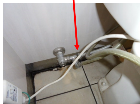
ウォシュレットの分岐金具とタンクへの給水管(ブレード管)の接合部から水漏れしていました
